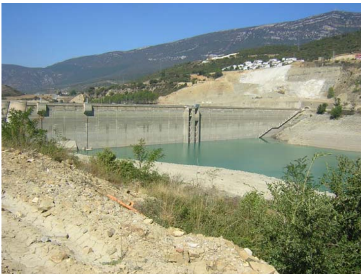
Figura 12.- Fotografía de septiembre de 2005, donde se observa el gunitado.
